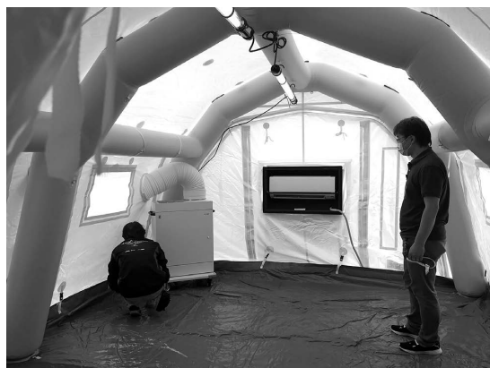
写真1 発熱患者待機用の陰圧 TENT を設置している様子。
